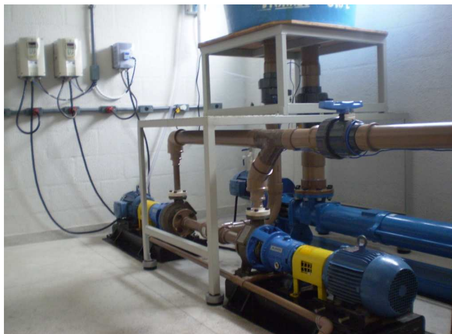
Figura 10 - Casa de bombas
